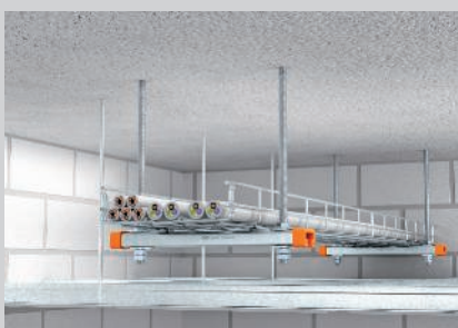
Instalação no teto de um nível, por cima do teto suspenso de proteção contra incêndios.
