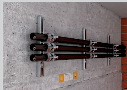
Instalação economizadora, de vários tubos lado a lado, com as abraçadeiras BBS.
