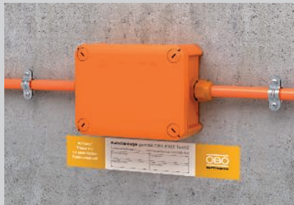
FireBox já instalada com placa de identificação.
