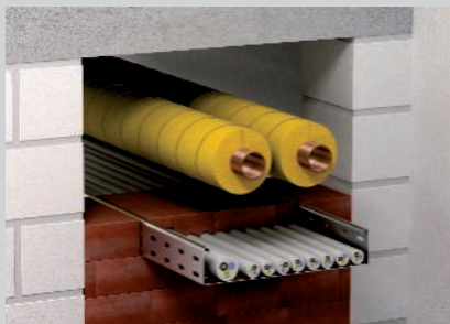
Utilização de tubos não inflamáveis com selagem de passagens.
