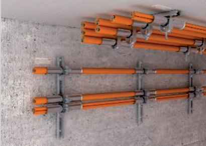
Instalação horizontal de cabos com abraçadeiras BBS e suportes longos na parede e no teto.
