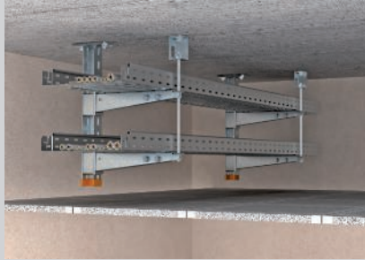
Suspensão no teto a dois níveis com colocação de consolas num dos lados.
